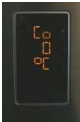
Compresseur à l'arrêt
